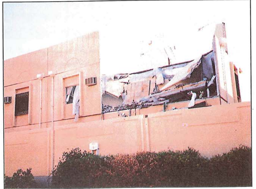
● تصدع نتيجة لانفجار سخان مياه .
